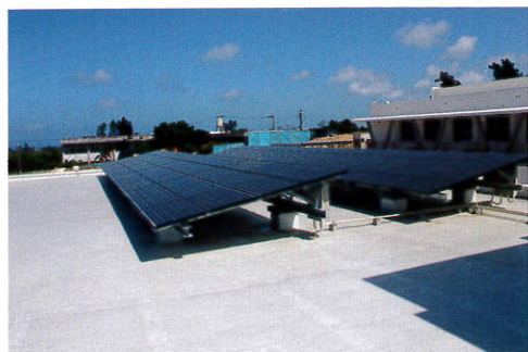
屋上に設置された太陽光パネル
